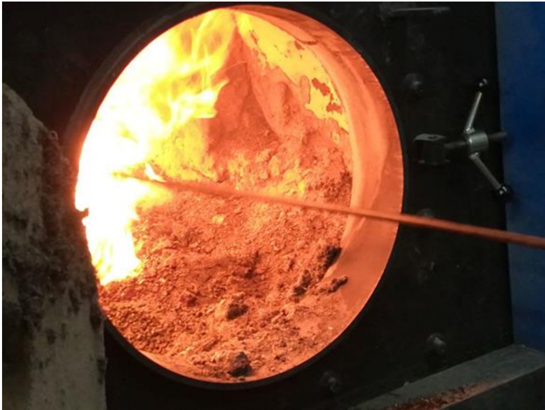
Abbildung 4: Blick in den Kessel des Heizwerks Malchin (Foto: G. Kabengele)
